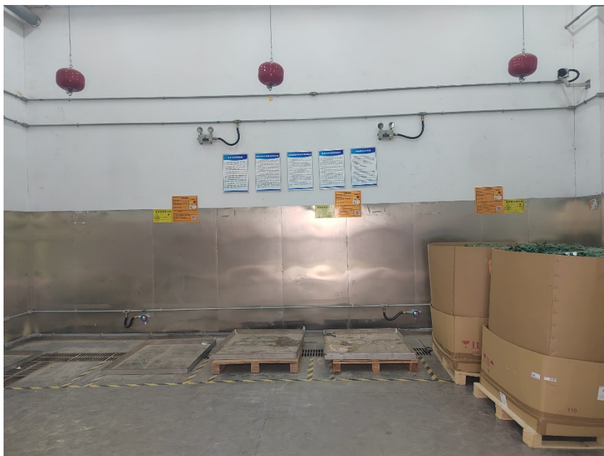
图 5.3.1 危废仓内部照片
